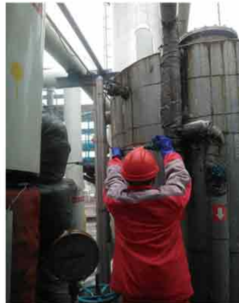
（图为生产加氢外操正在对制氢装置伴热线检查）
