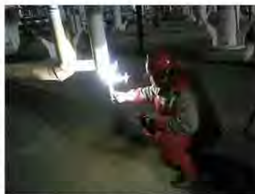
（图为夜班人员对V304滴漏进行处理）
